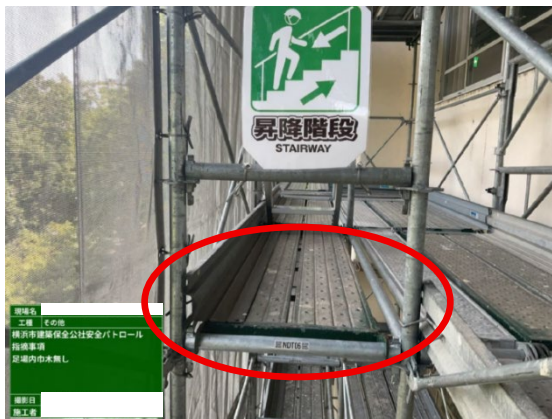
改善指示 足場内巾木なし 是正前
