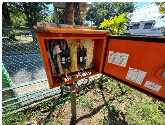
仮設電源の点検
