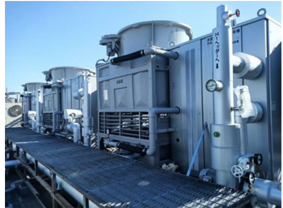
施工後（冷却塔一体型吸収冷温水機）
