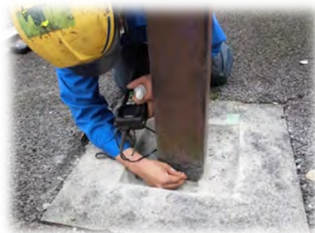
外灯ポール腐食状況確認(超音波測定器)
