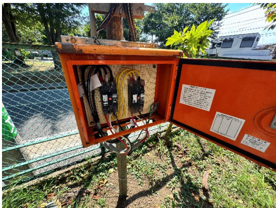
仮設電源の点検
