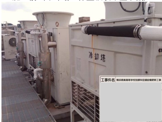
施工前（冷却塔一体型吸収冷温水機）
