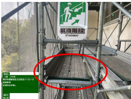
改善指示 足場内巾木なし 是正前
