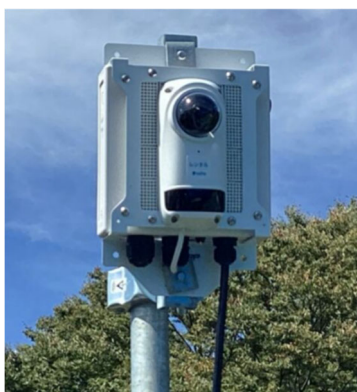
設置されたWebカメラ
