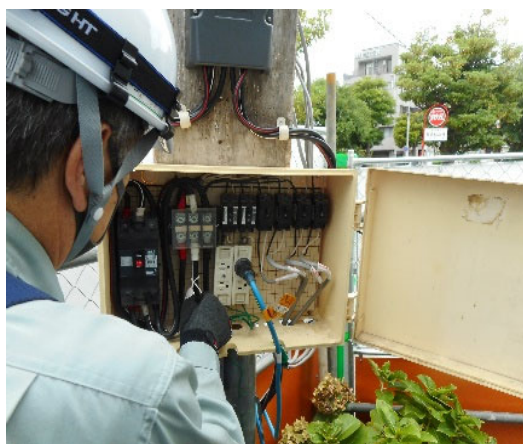
仮設電気の点検
