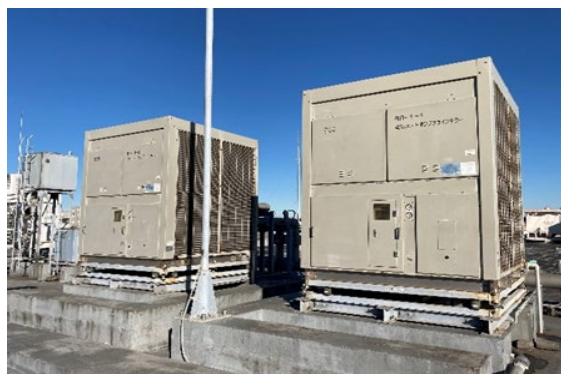
ヒートポンプユニット外観
