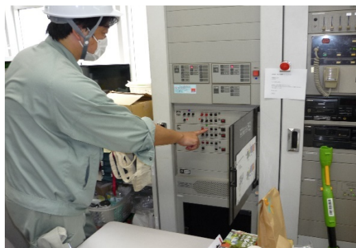
防火設備点検の様子
