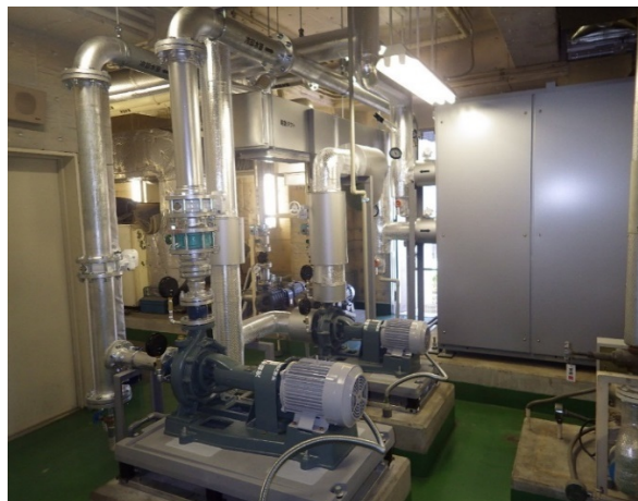
施工後（熱源機器（ポンプ・吸収冷温水機））
