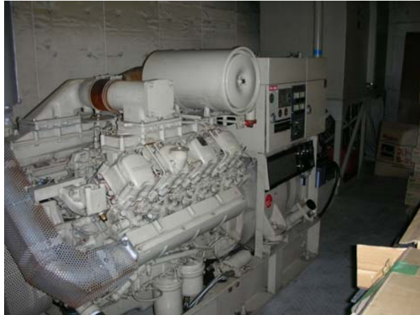
非常用発電機
