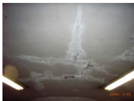
天井スラブのクラックと白華
