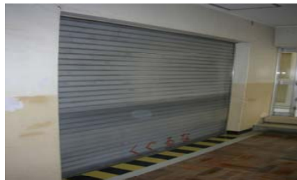
防火シャッター
