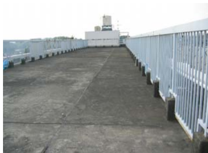
屋上防水・スチール手すり改修前
