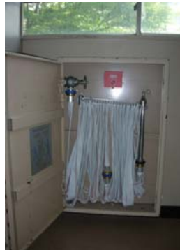
消火栓ボックス内部
