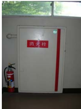
消火栓ボックス
