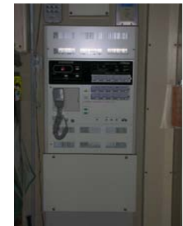
非常放送アンプ
