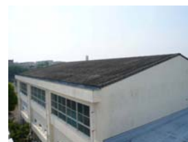
スレート屋根の劣化
