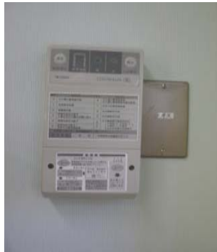
操作盤(ガス遮断弁用)
