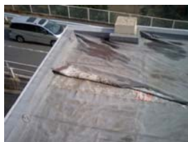
屋上シート防水めくれ
