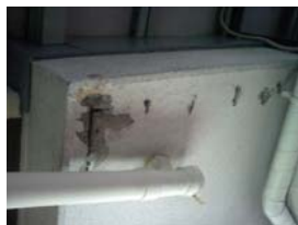
底上げ裏爆裂
