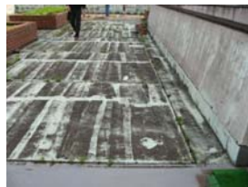
屋上防水劣化
