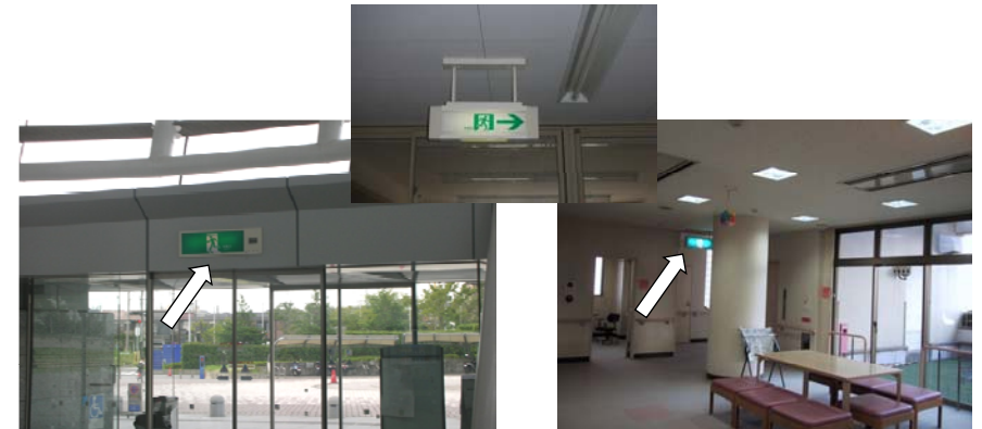
避難口誘導灯
