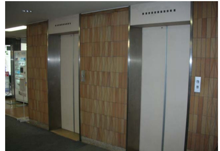
エレベーター出入口
