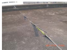
屋上伸縮目地めくれ
