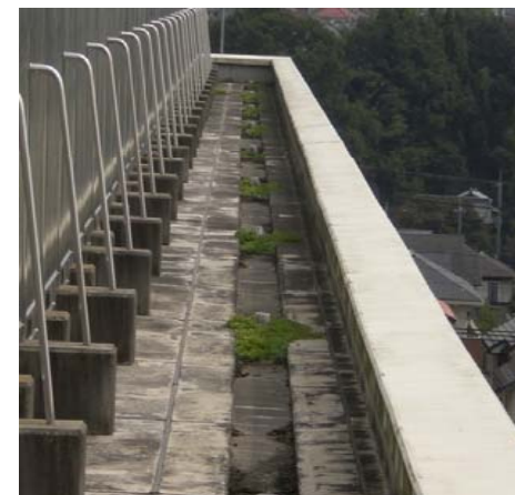
屋上の排水溝とルーフドレインが土と草で埋まっている
