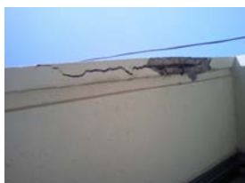
手摺天端の爆裂
